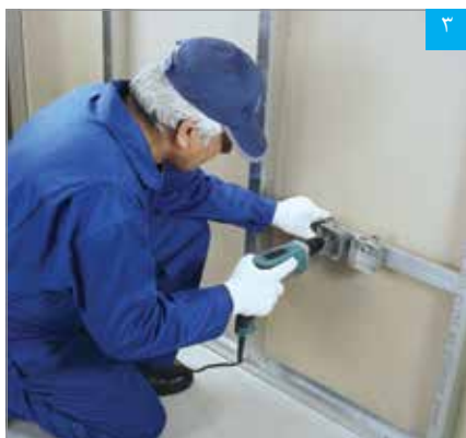
اتصال قوطی برق به سازه پشتیبان
