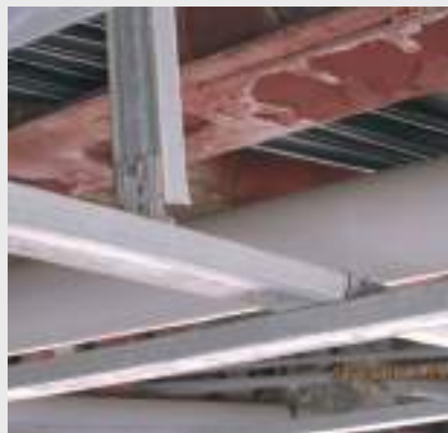
عدم اجرای جزئیات آویزگیری
