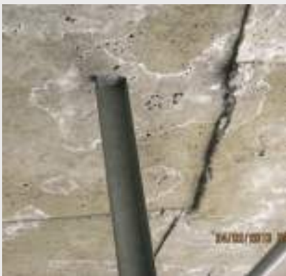
عدم استفاده از اتصال مناسب به سقف اصلی
