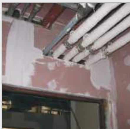
عدم رعایت الزامات کد حریق
